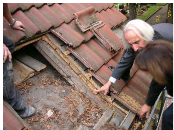
Nachweis der früheren Dacheindeckung mit Schiefer
